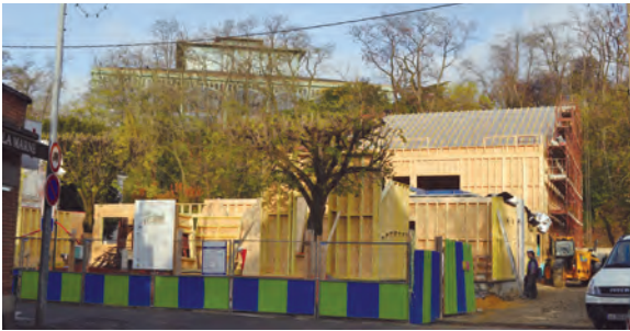
Un bâtiment en ossature bois au pied du Pavillon Baltard de Nogent-sur-Marne (crédit photo : SAS Briand)
