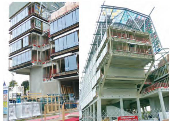
Une double peau sur une structure en béton (crédit photo : Philippe Outrequin)
