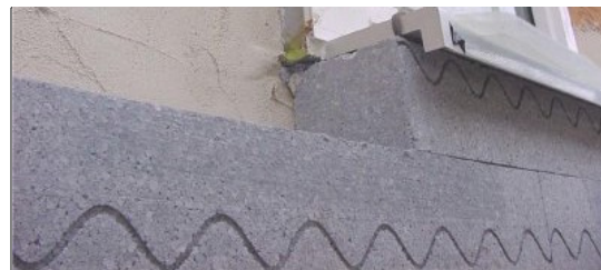
Photo de chantier: Le rejointoyage sur l'ancien enduit est bien visible, tout comme l'isolation particulièrement bien travaillée sous l'appui de fenêtre. (Photo: Schulze-Darup)
