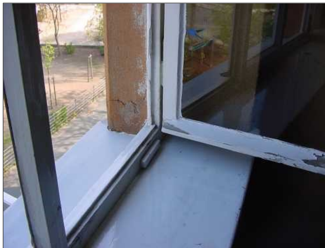
Une fenêtre en bois, perméable et très mal isolée - une rénovation est plus que nécessaire.
